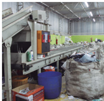
Esteira para triagem de material
